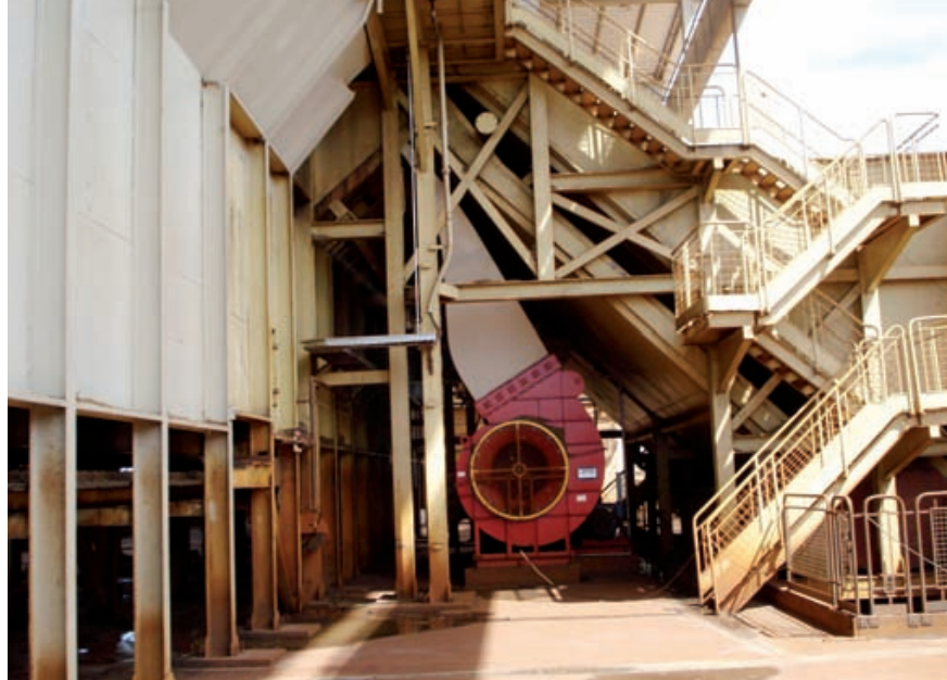
Sistema de injeção de ar
